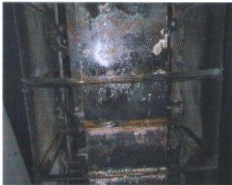
焼損した粗大ごみ処理施設内設備
